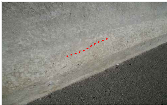
방호벽 상행선 S2 균열(폭 0.2mm)
