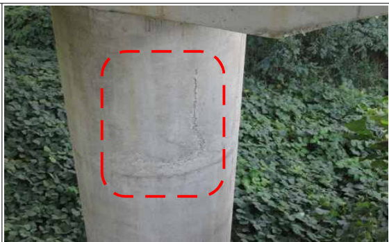
교각 상행선 P1 기둥부 정면 재료분리
