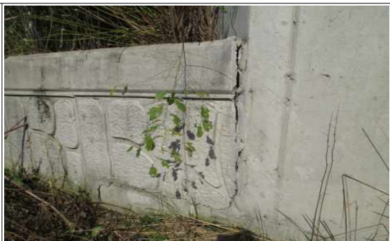
교대 군도8호선방향 A1 벽체 집합부 실란트 손상
