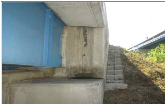
신축이음 A2 하부 누수(교대 상면 체수)
