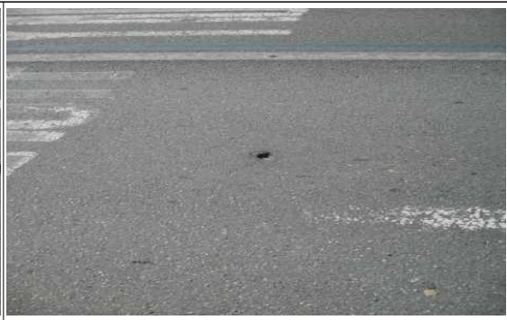
교면포장 상동IC방향 S5 포트홀
