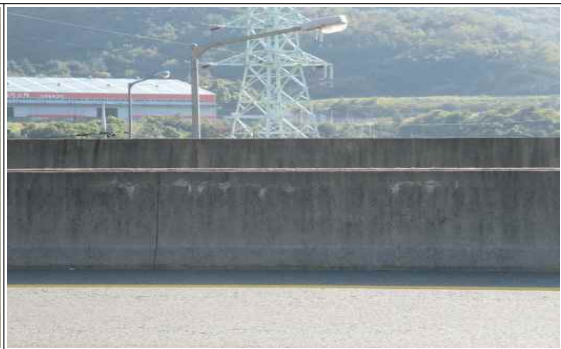
중분대 상행선 S2 균열부 백태
