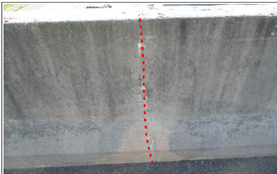
방호벽 하행선 S3 균열(폭 0.4mm)
