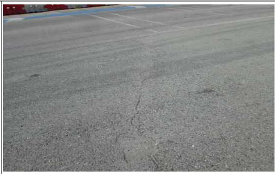
교면포장 상동IC방향 S1 아스콘 균열
