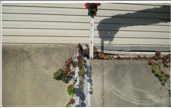
상행선 A1측 접속도로 방호벽 단차
