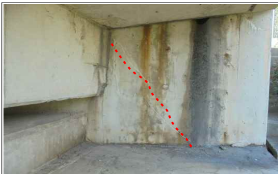
교대 상동IC방향 A1 홍벽 균열(폭 0.2mm) 및 누수흔적
