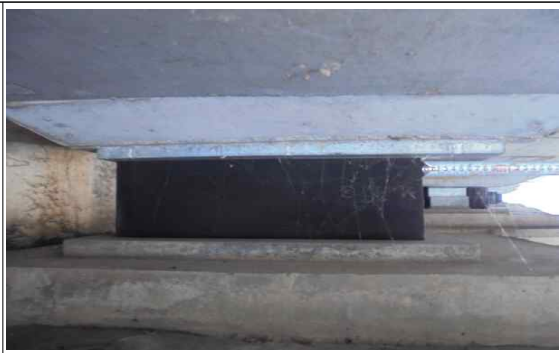
교량반침 상행선 A2 SH3 본체 고무재 밀림(약 40mm)
