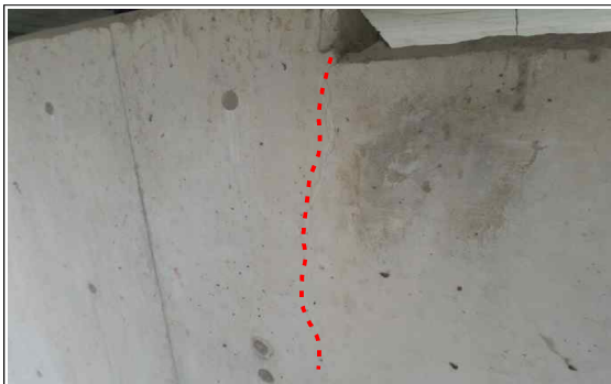
교각 하행선 P2 코핑부 배면 균열(폭 0.3mm)
