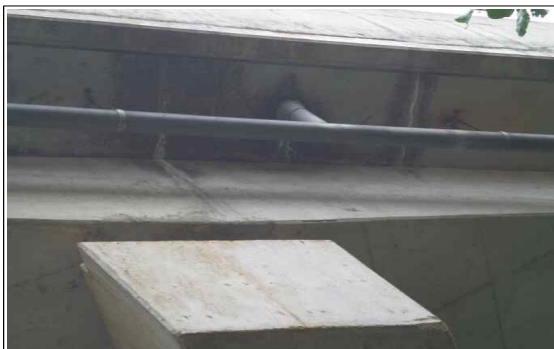
바닥판하면 상행선 S2 백태
