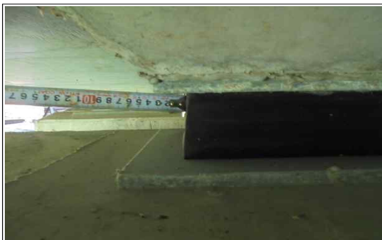
교량받침 상동IC방향 A2 SH5 고무재 밀림
