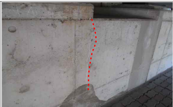
교대 상행선 A2 벽체 균열(폭 0.1mm)
