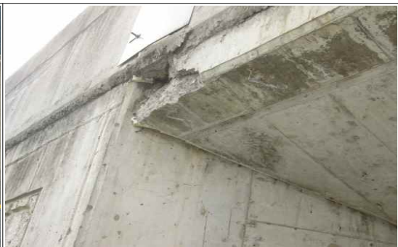
바닥판하면 상행선 S1 콘크리트 박락
