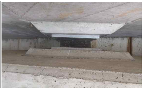
교량받침 하행선 A1 SH4 무수축물탈 균열(폭 0.1mm)
