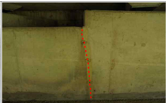
교대 군도8호선방향 A2 벽체 보수부 재균열(폭 0.2mm)
