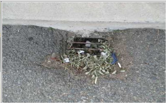
배수시설 군도8호선방향 S3 배수구 이물질퇴적
