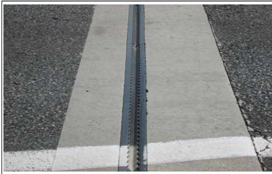
신축이음 하행선 A1 고무재 손상
