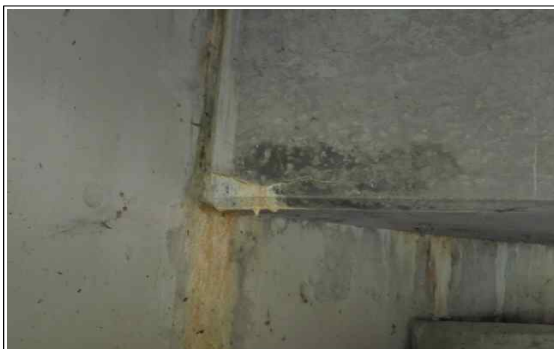
바닥판하면 하행선 S1 백태
