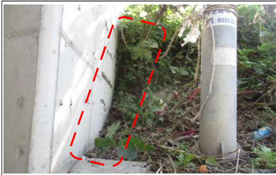
옹벽 군도8호선 방향 A1측 하부 토사유출
