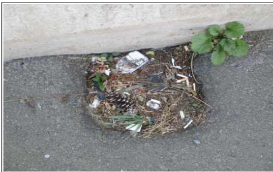
배수시설 하행선 S1 배수구 이물질퇴적
