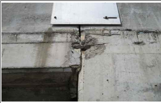
교대 A2 우측 날개벽 콘크리트 박락
