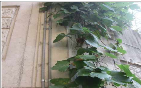
교대 하행선 A1 벽체 접합부 실란트 손상
