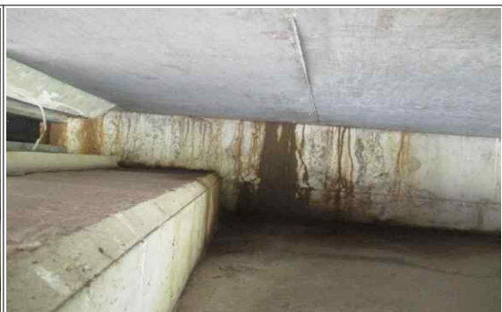
신축이음 상행선 A2 하부 누수(교대 홍벽 누수흔적)
