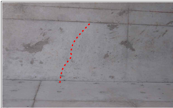
바닥판하면 하행선 S1 균열(폭 0.2mm)
