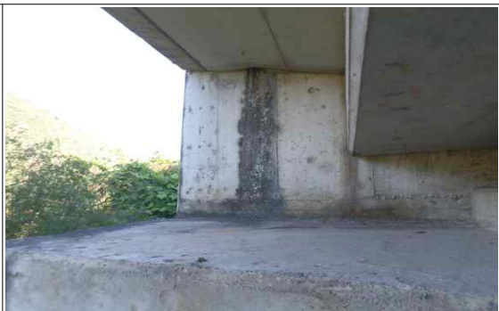
교대 상행선 A1 흉벽 누수흔적
