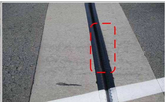
신축이음 하행선 A2 고무재 손상
