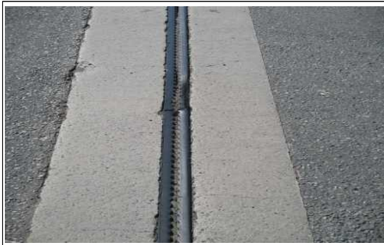
신축이음 상동IC방향 A2 본체 고무재 손상
