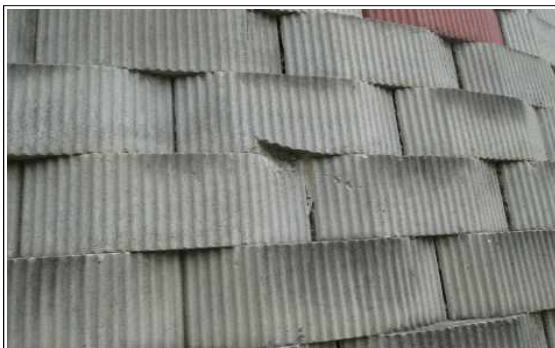
하행선측 보강토 옹벽 국부 박락
