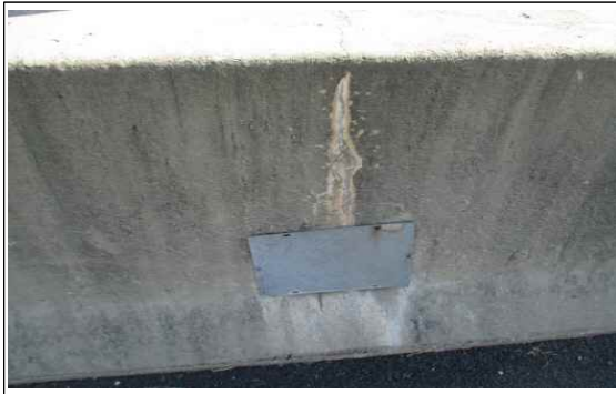
방호벽 S1 수직균열(폭 0.1mm)
