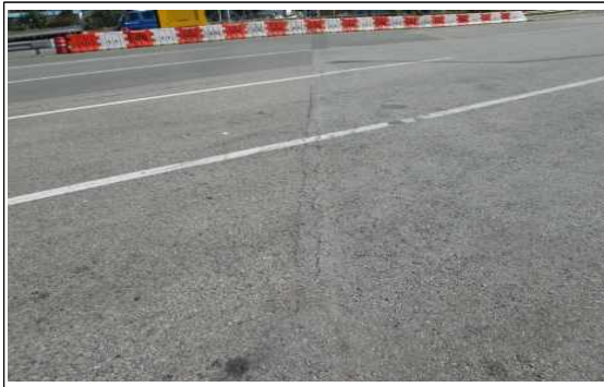
교면포장 군도8호선방향 S1 아스콘 균열
