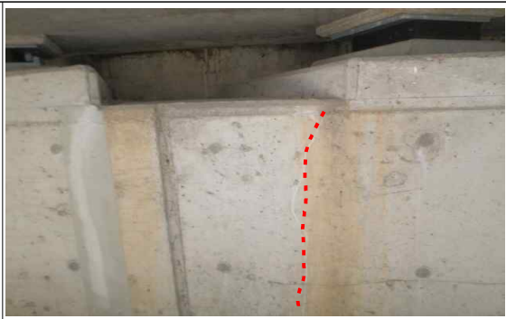
교대 상행선 A2 벽체 균열(폭 0.3mm)
