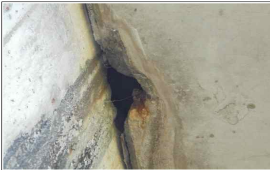
배수시설 상행선 S1 유도배수관 길이 부족
