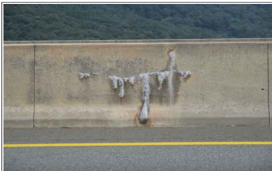
방호벽 하행선 S1 균열부 백태
