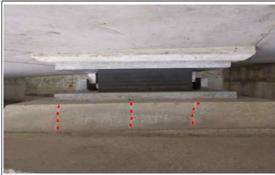
교량받침 하행선 A2 SH4 무수축물탈 균열(폭 0.1mm)
