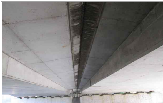
바닥판하면 상·하행선 S2 누수흔적(접합부 누수)
