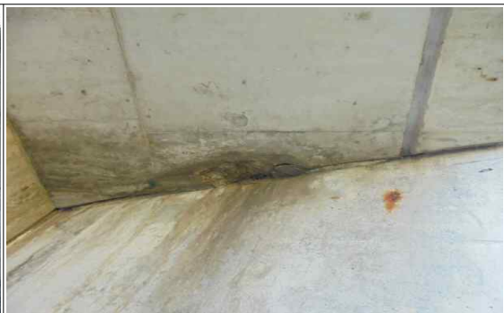
바닥판하면 상행선 S3 콘크리트 박락
