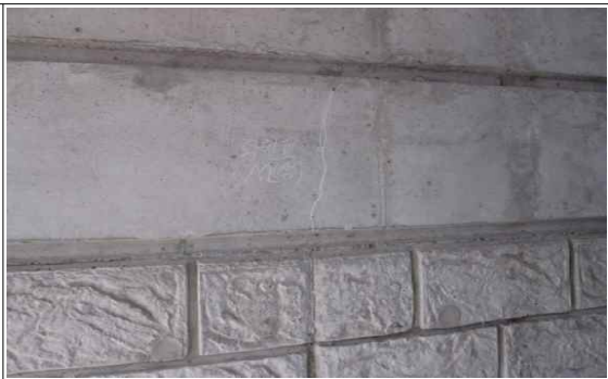
교대 상행선 A2 벽체 균열(폭 0.1mm)
