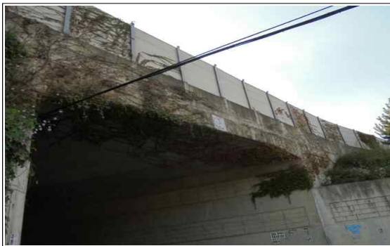
바닥판하면 상행선 S1 측면 누수로 인한 오염
