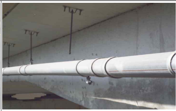
배수시설 하행선 S2 배수관 연결고리 탈락
