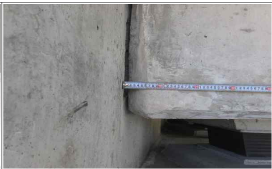
상행선 S1 A1측 바닥판 유간 부족
