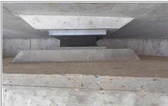
교량받침 하행선 A2 SH2 무수축물탈 균열(폭 0.1mm)
