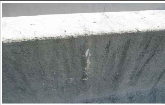
방호벽 S1 수직균열(폭 0.2mm)
