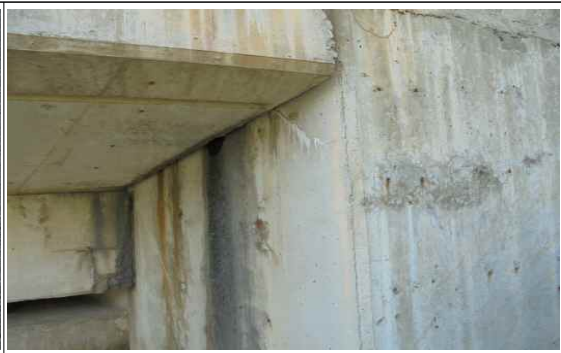
신축이음 상동IC방향 A1 하부 누수(교대 홍벽 누수흔적)
