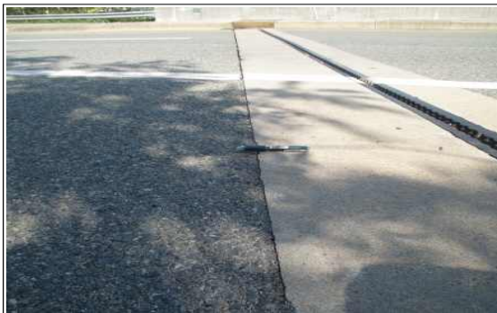
신축이음 군도8호선방향 A1 접속부 이격 및 단차
