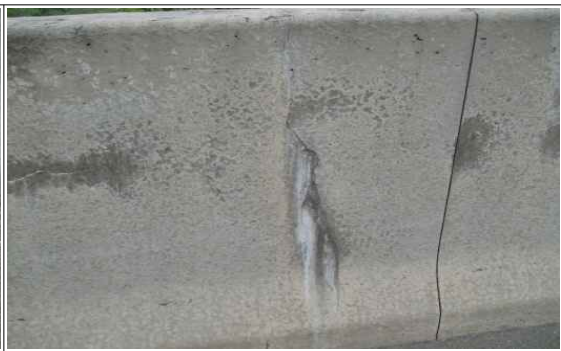
방호벽 상행선 S4 균열부 백태
