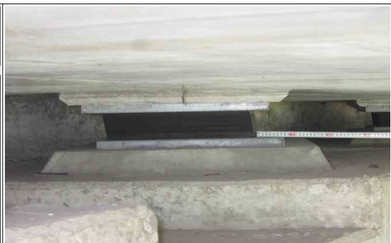
교량받침 상행선 A1 SH5 고무재 밀림
