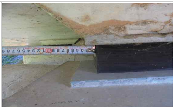
교량받침 군도8호선방향 A2 SH5 고무재 밀림
