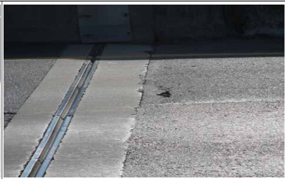
교면포장 상행선 A2측 접속도로 패임
