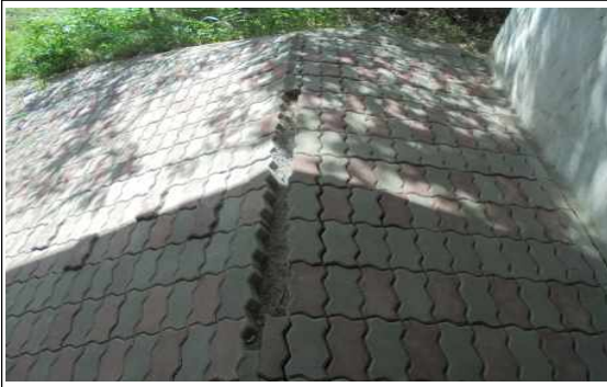
군도8호선방향 A1 법면 보호블럭 탈락
