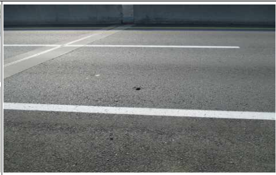
교면포장 상행선 A2측 접속도로 포트홀
