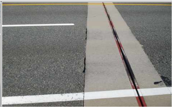
교면포장 하행선 A2측 접속도로 패임
