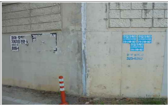
교대 상행선 A1 실란트 손상
