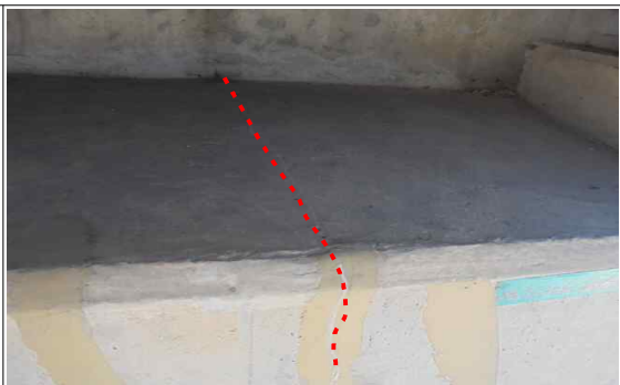
교대 A1 벽체 균열(폭 0.2mm)
