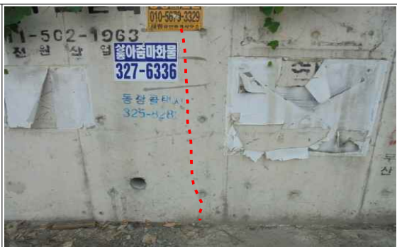
옹벽 상행선 A1 좌측 균열 (폭 0.2mm)
