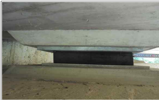
교량받침 하행선 A1 SH3 고무재 밀림
