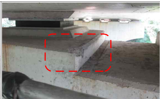
교량받침 상행선 P1 SH5 받침콘크리트 박락
