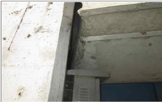
바닥판하면 S1(A2측) 콘크리트 박락
