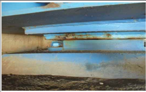
교량받침 상행선 A1 SH2 Plate 녹발생
