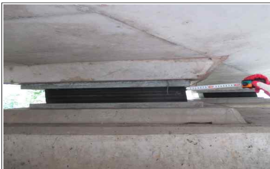
교량받침 상행선 P3 SH5 고무재 밀림
