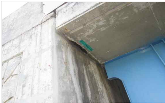
바닥판하면 S1(A1측) 신축이음 하부 누수흔적
