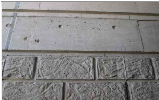
교대 하행선 A1 벽체 균열(폭 0.3mm)
