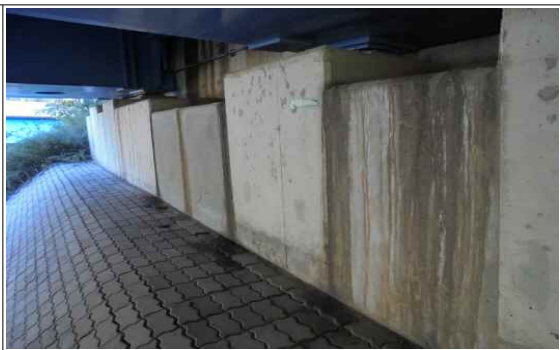
교대 상행선 A1 벽체 누수흔적
