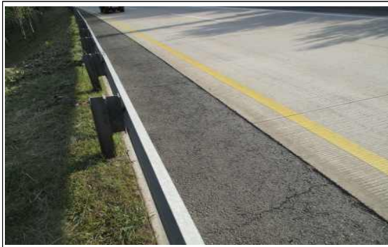
교면포장 하행선 S1 아스콘 균열
