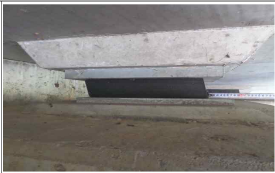
교량받침 상행선 A2 SH5 고무재 밀림
