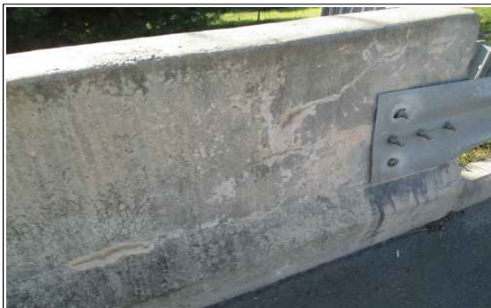
방호벽 하행선 A2측 접속도로 망상균열
