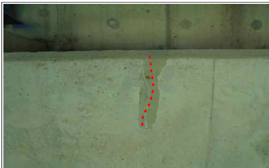
교대 하행선 A1 벽체 보수부 재균열(폭 0.1mm)
