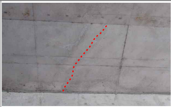
바닥판하면 상행선 S1 균열(폭 0.3mm)
