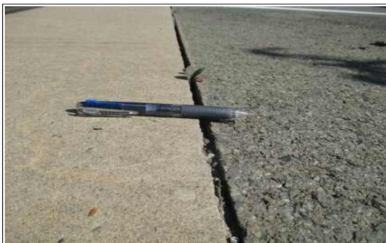
신축이음 하행선 A1 후타재 접속부 이격 및 단차
