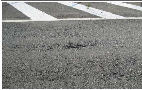
교면포장 상행선 S1 패임
