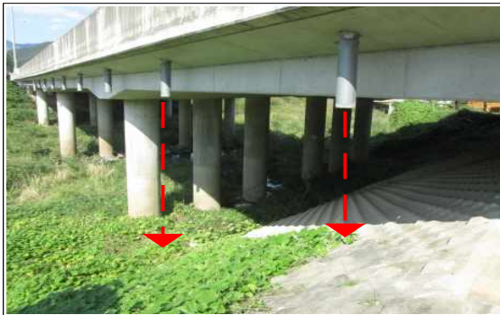
배수시설 군도8호선방향 S5 배수관 위치불량(법면 상부)
