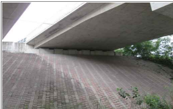
교대 상행선 A2 벽체 누수흔적
