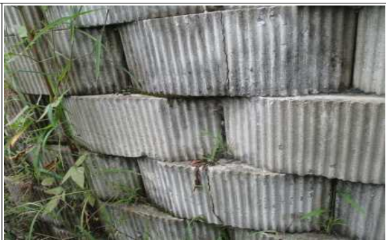
상행선측 보강토 옹벽 블럭 균열
