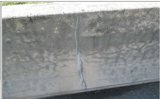
방호벽 군도8호선방향 S2 균열부 백태
