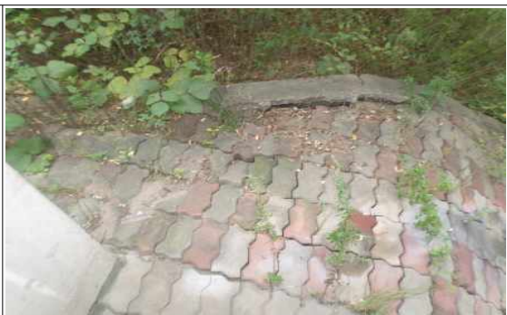
상행선 A2 범면 침하 및 공동 발생
