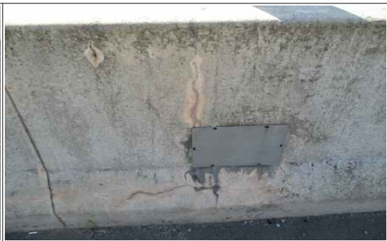
방호벽 하행선 S1 균열(폭 0.2mm)
