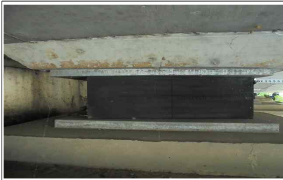
교량반침 상행선 A1 SH3 본체 고무재 밀림(약 40mm)
