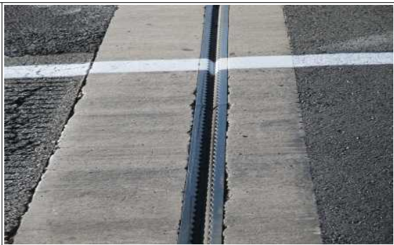
신축이음 A1 본체 고무재 손상
