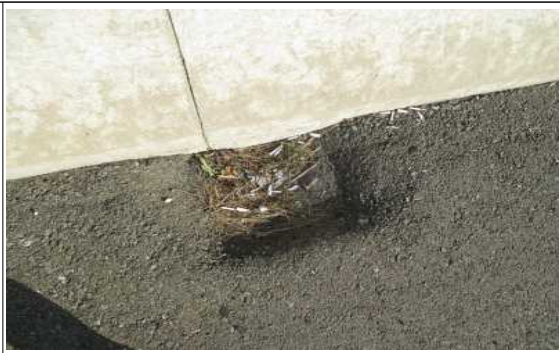
배수시설 S1 배수구 이물질퇴적
