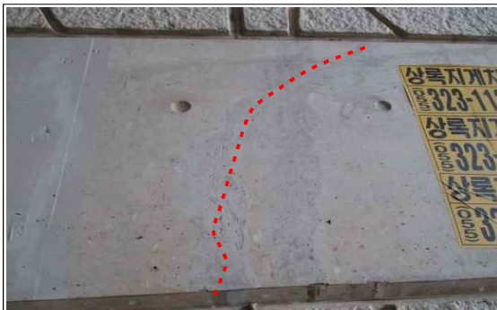
교대 상동IC방향 A1 벽체 균열(폭 0.3mm)
