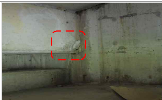
바닥판하면 군도8호선방향 S1 콘크리트 국부 박락
